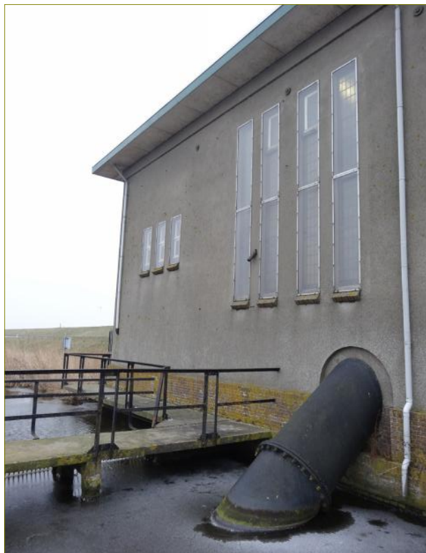
Aanzuigbuis centrifugaalpomp in westgevel
