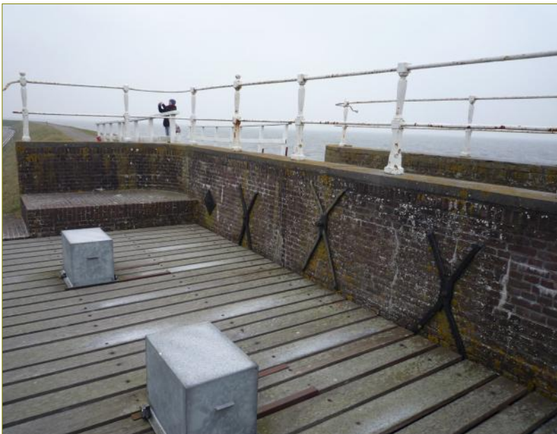
Binnenzijde keermuur en moderne bediening van afsluitschuiwen
