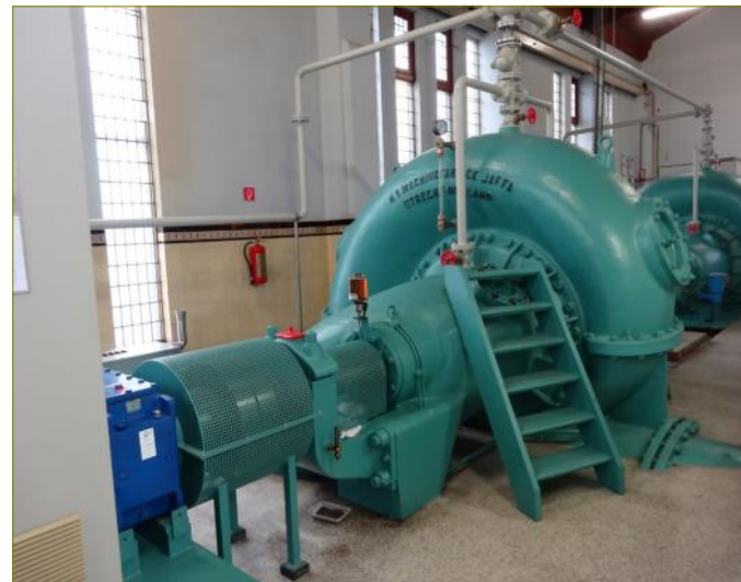
Aandrijving centrifugaalpomp door nieuwe elektromotor
