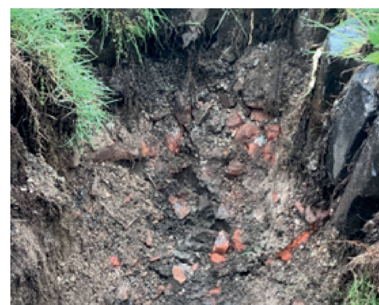
Voorbeeld asbest onder zetsteen (dijkvak 2 Zuidkade)
